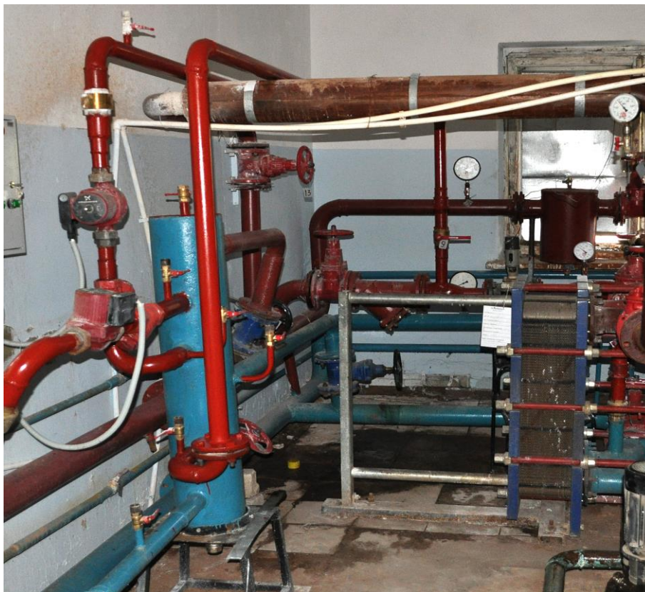
Рис. 7. Экспериментальный образец термогидравлического распределителя, установленный в индивидуальном тепловом пункте «Гараж»
